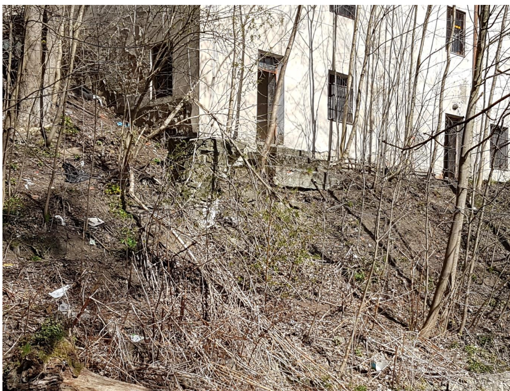
Fot. 5. Widok z brzegu prawego na przedmiotowy budynek i fragment muru. Zbliżenie na ruiny muru. Zdjęcie wykonane podczas inwentaryzacji WTU w kwietniu 2020.
